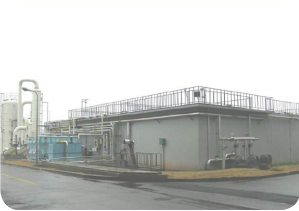
生活污水处理设施
