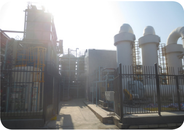
氨氮废水处理设施
